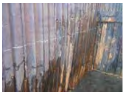
洗浄時の欠損確認
