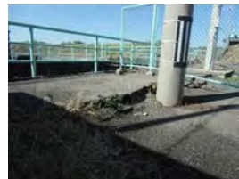
地盤沈下で発生した施設内の段差
