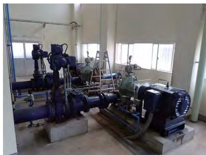
主ポンプ設備改修前
