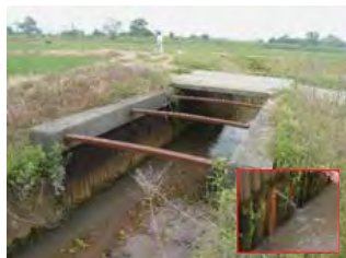
施設現状と劣化状況
