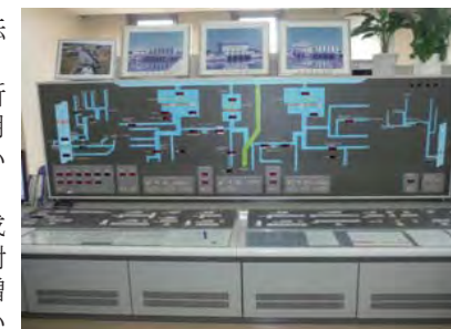
既設排水管理施設
