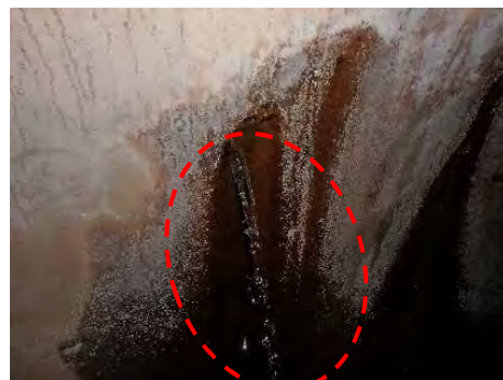
新江導水路 隧道区間の湧水
