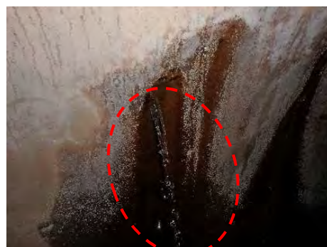
新江導水路 隧道区間の湧水
