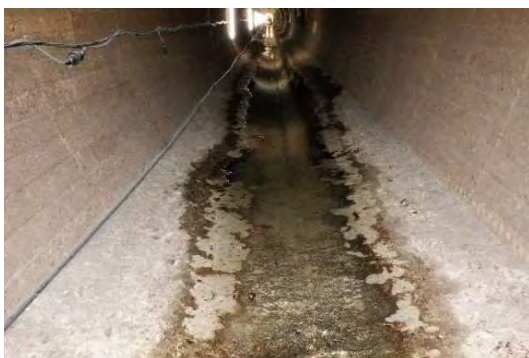
改修前のトンネル底版
