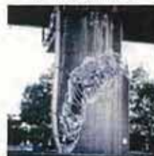
参考写真 RC構脚のせん断破壊 平成7年1月17日：西宮市、目黒公園、東京大学
