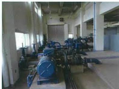
主ポンプ設備改修前
