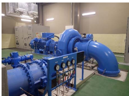
小水力発電施設の視察
