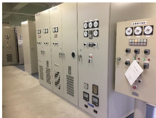
新しくなった電気設備
