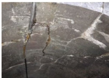
ひび割れ(坑口部)
