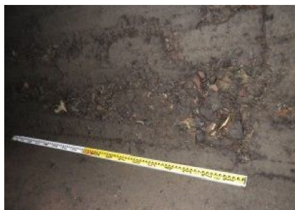
コンクリート壁面の欠損
