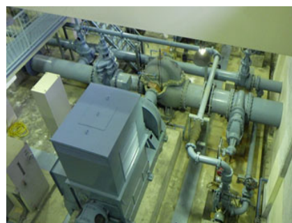
揚水機場のポンプ設備
