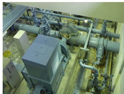
揚水機場のポンプ設備
