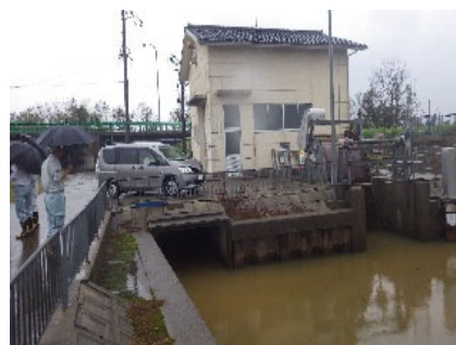
中嶋排水機場
