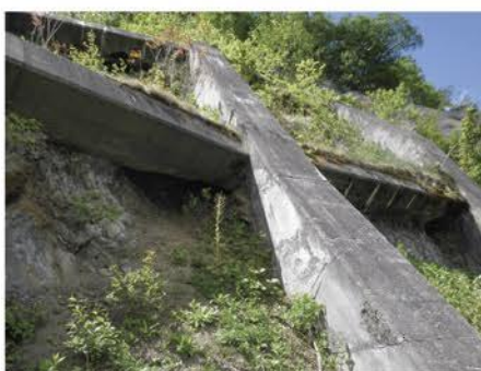
右岸法枠工の中詰め空洞
