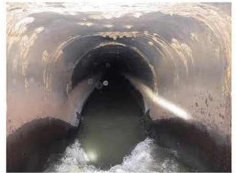
三丈掘トンネル(櫛池川横断管の腐食)
