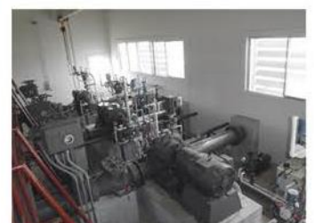
県営ほ場整備 揚水機場(42機場)
