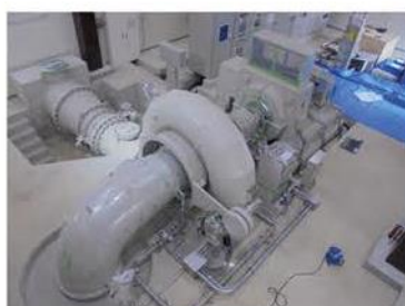
小水力発電設備
