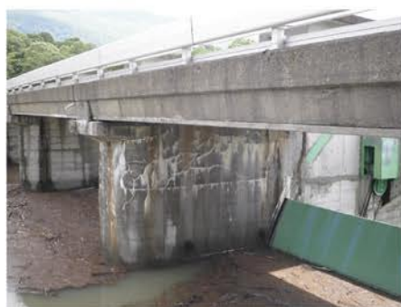
洪水吐堰柱のひび割れ
