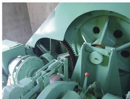
洪水吐巻き上げ機の摩耗
