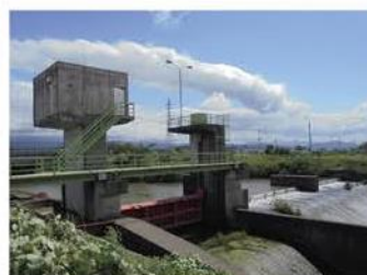
国営子安頭首工(現況)
