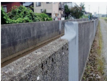
昭和江幹線用水路 地盤変状による水路壁ズレ
