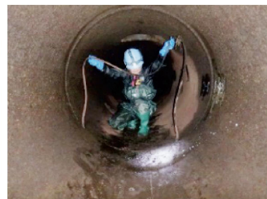
昭和江用水路 継手の離脱
