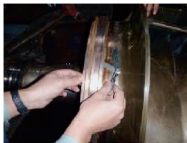
昭和江揚水機場 回転体の摩耗
