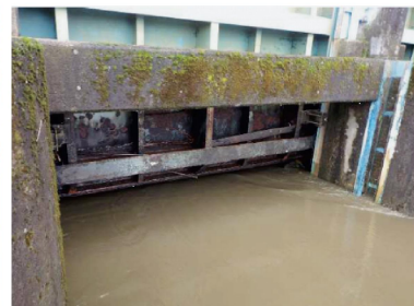
刈谷田川右岸排水機場 自然排水ゲート腐食
