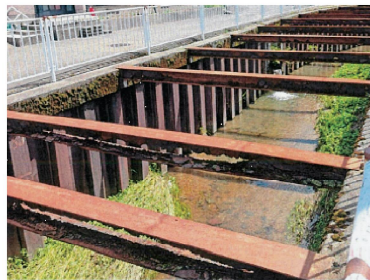
高位部幹線排水路 切梁H鋼の腐食
