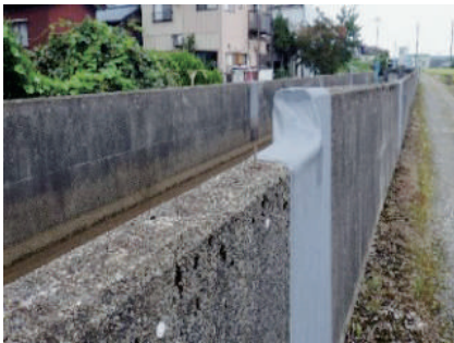
昭和江幹線用水路 地盤変状による水路壁ズレ
