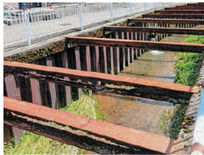
高位部幹線排水路 切梁H鋼の腐食
