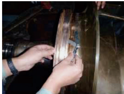
昭和江揚水機場 回転体の摩耗
