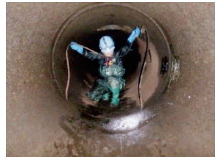
昭和江用水路 継手の離脱
