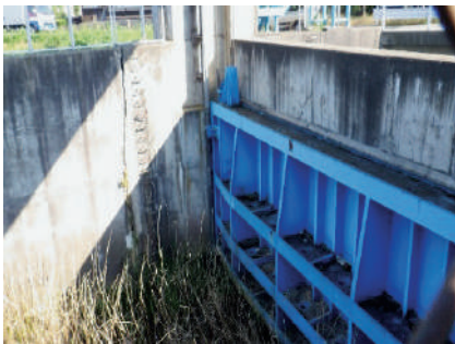
貝喰川逆流防止水門 側壁クラック箇所
