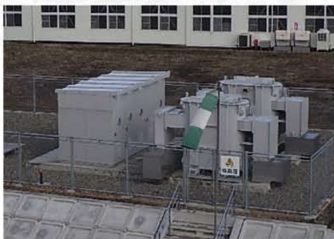
特別高圧受変電設備
