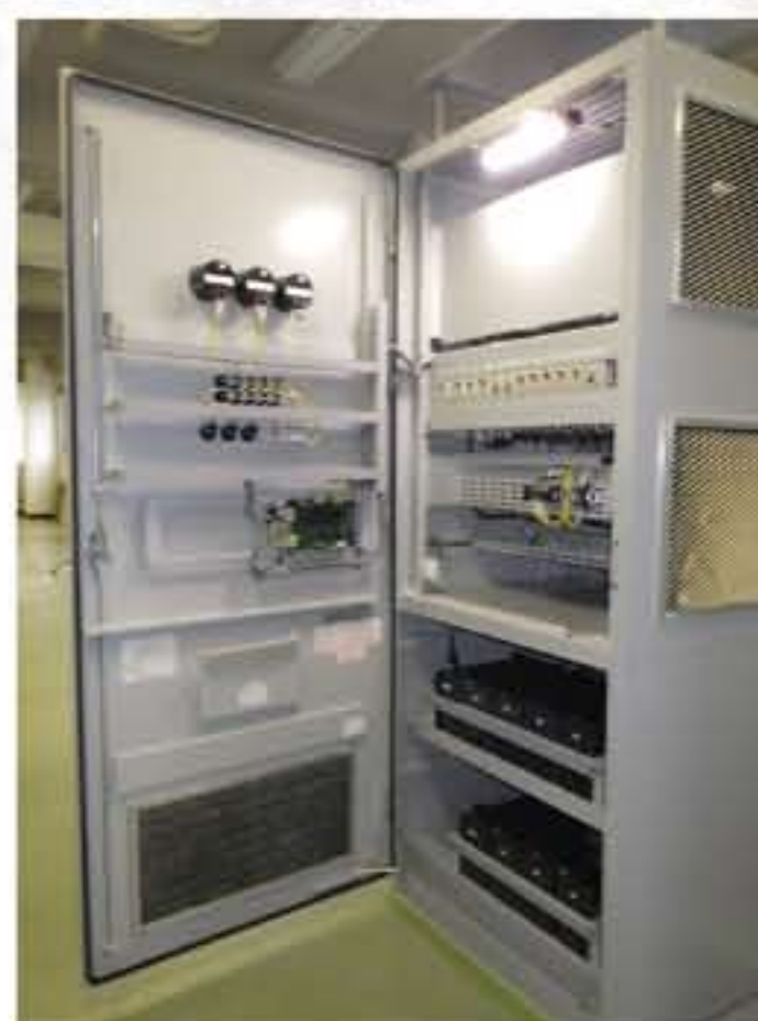
特別高圧変電設備(ポンプ場電気室)
