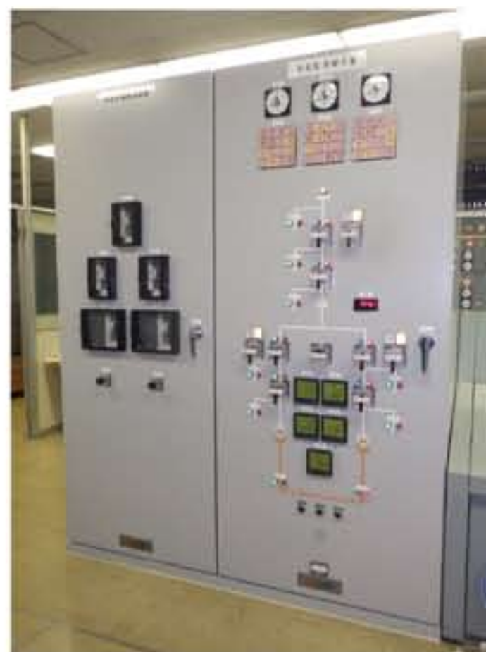
特別高圧変電設備(中央監視室)
