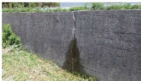
【右岸幹線用水路】 (目地部分からの漏水)
