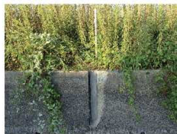
【新江幹線用水路】 (目地部コンクリート剥離)
