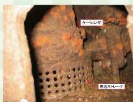
揚水ポンプの腐食
