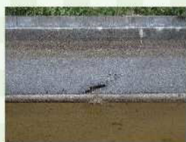
コンクリート用水路の欠損
