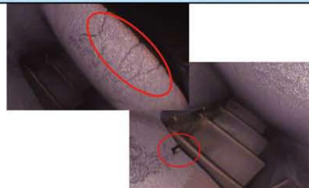
ガスタービンのタービンノズルの亀裂と欠損
