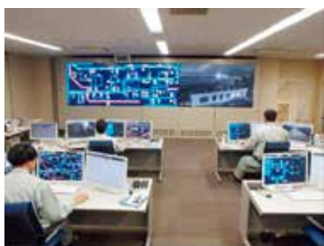
土地改良区での監視・操作の様子
