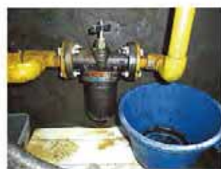
中間補給揚水機場 補器類からの油漏れ
