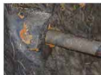
中間補給揚水機場 ポンプ軸受部の摩耗損傷
