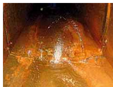
トンネル目地部からの漏水 (左岸低位西幹線用水路)
