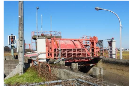
■ 焼田川サイホン除塵設備 (2号幹線用水路高梨町地内)
