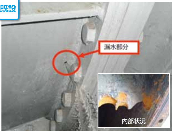
▲腐食が進行した既設のケーシング
