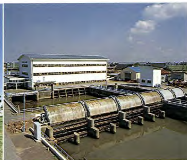
鎧潟排水機場
