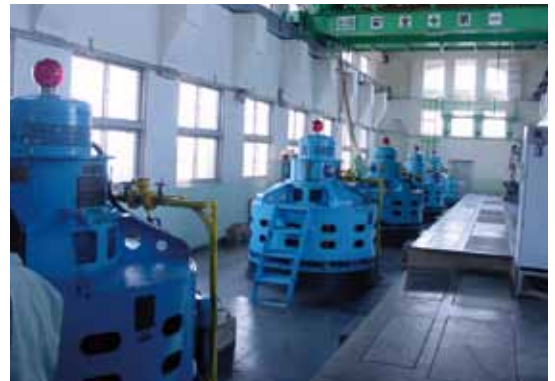
▲旧機場の立軸軸流ポンプ
