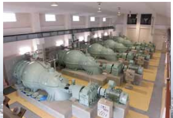
▲新機場の横軸斜流ポンプ
