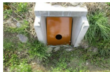
【水田貯留板設置(田んぼダム)】
