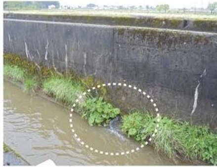
開水路の漏水(中江用水路)
