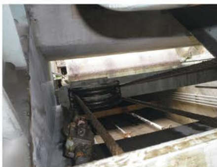
取水ゲートの腐食
