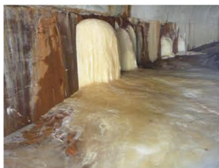
左岸道路トンネルの凍上
