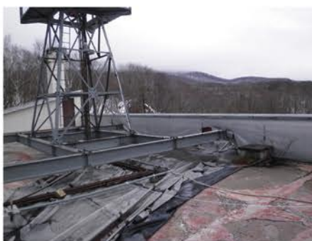
ダム管理棟屋上の漏水
