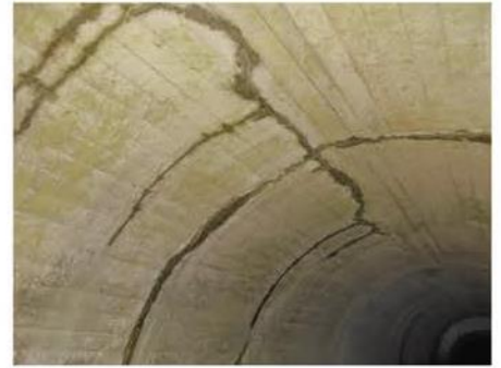
トンネルのひび割れ(アーチ部に空隙)
