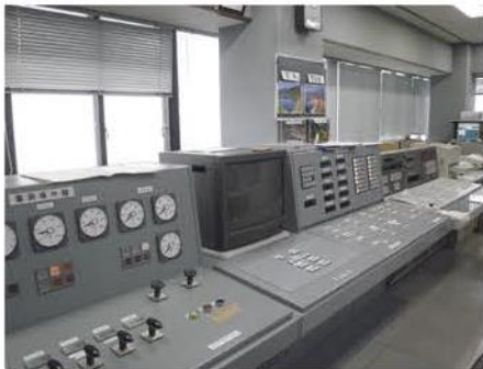
笹ヶ峰ダム監視制御装置(現況)
