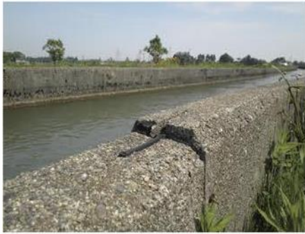
開水路の浮上(中江用水路)
