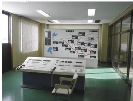
中央管理所監視装置(現況)
