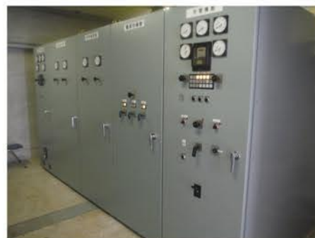
電気設備の経年劣化
