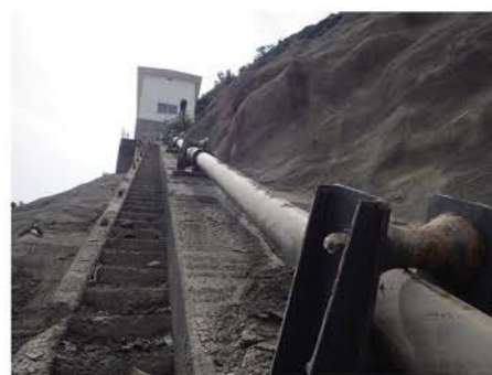
緊急放流ゲートの老朽化
