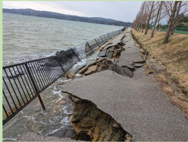
地震後の被災状況 (R6.1)
