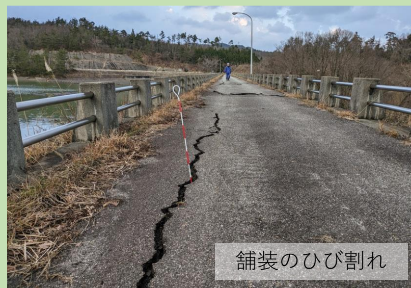
地震後のダム堤体の被災状況
