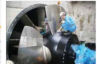
<新川河口排水機場>
