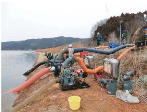
宮城県石巻市 いしのまきし ：災害ポンプの稼働状況
