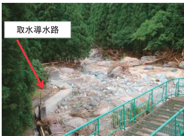
取水導水路土砂堆積状況（新潟（魚野川東部地区））
