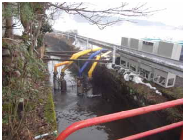
災害応急用ポンプ設置状況（新潟上越）
