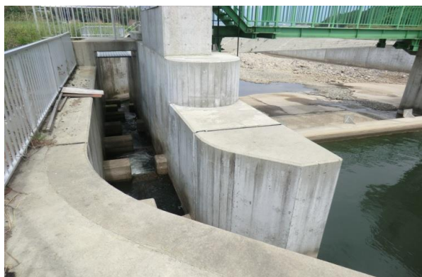
【小倉川頭首工に設置された魚道】
