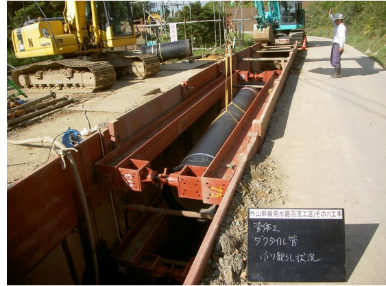
【外山幹線用水路】
