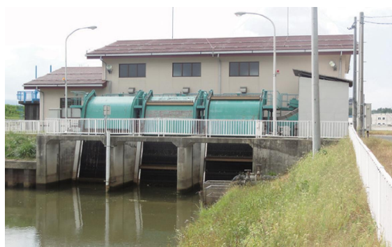
【国仲排水機場】
