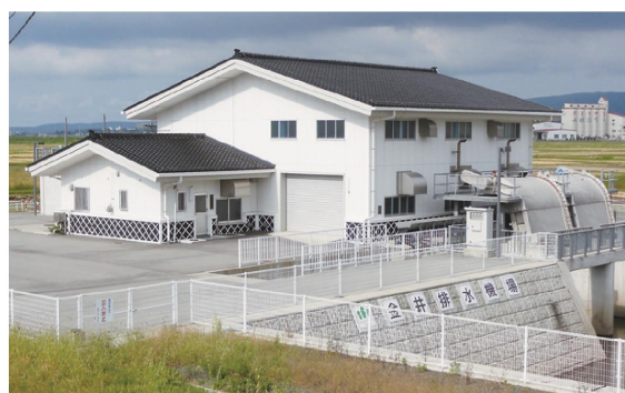
【金井排水機場】
