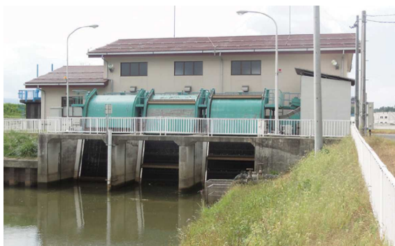
【国仲排水機場】
