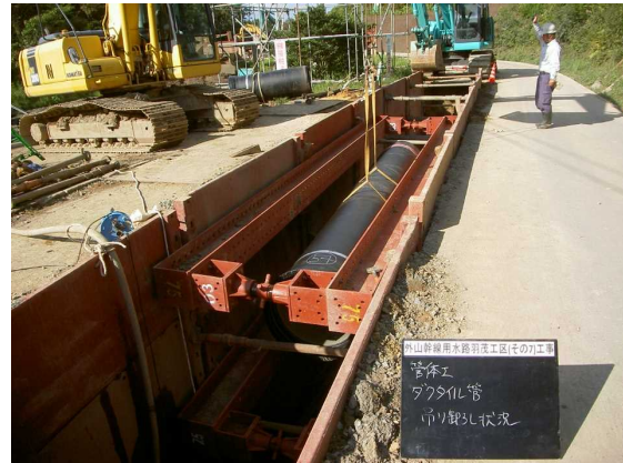
【外山幹線用水路】
