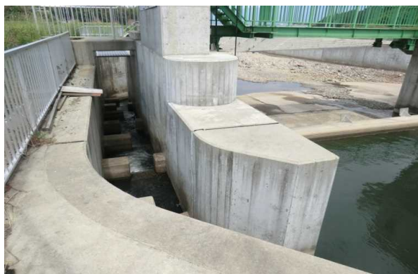
【小倉川頭首工に設置された魚道】
