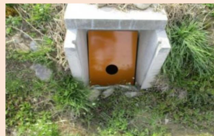
水田貯留版設置(田んぼダム)
