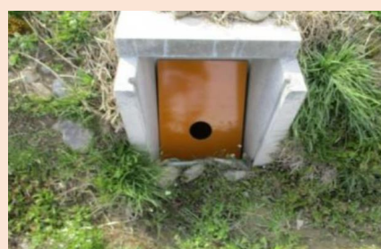
水田貯留版設置(田んぼダム)
