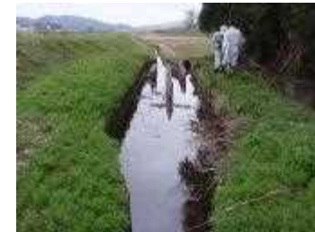
流量調整が容易にできない分水工
