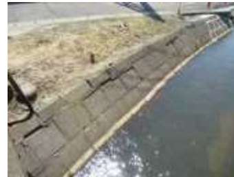
老朽化した用水路
