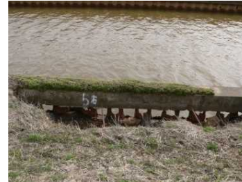
○鋼矢板からの背面土流出
