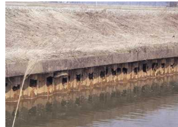
○鋼矢板護岸の著しい腐食
