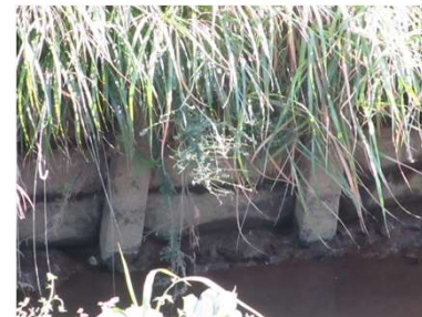
○柵板護岸の老朽化
