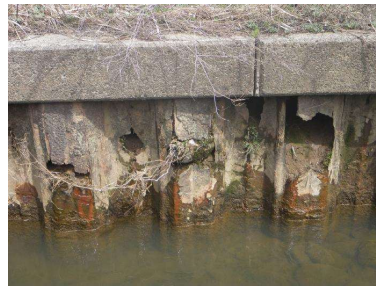
○鋼矢板護岸の著しい腐食
