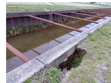
背面土の吸出し
