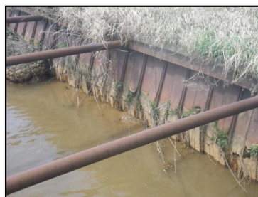
鋼矢板の腐食(はらみ出し)
