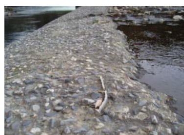
固定堰の摩耗 （加治川右岸頭首工）
