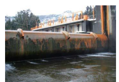
土砂吐ゲートの腐食 （加治川第1頭首工）
