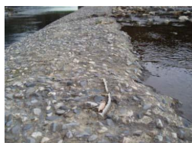
固定堰の摩耗 （加治川右岸頭首工）
