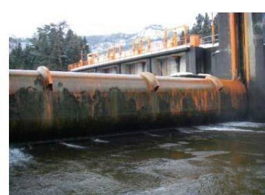
土砂吐ゲートの腐食 （加治川第1頭首工）
