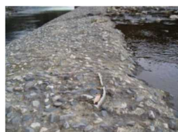
固定堰の摩耗 （加治川右岸頭首工）
