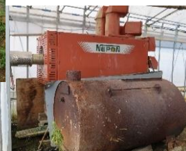
ハウスの暖房設備
