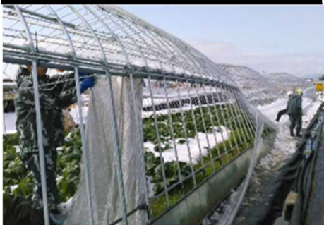
大雪により倒壊したハウス
