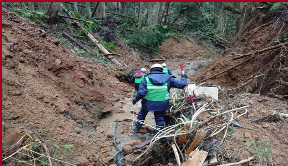
農道被災状況③
