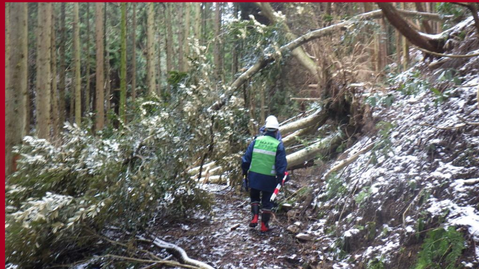
農道被災状況②
