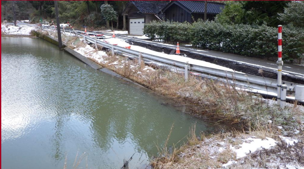
ため池被災状況③
