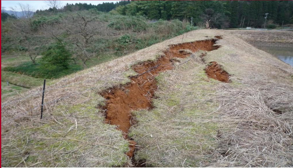
ため池被災状況①
