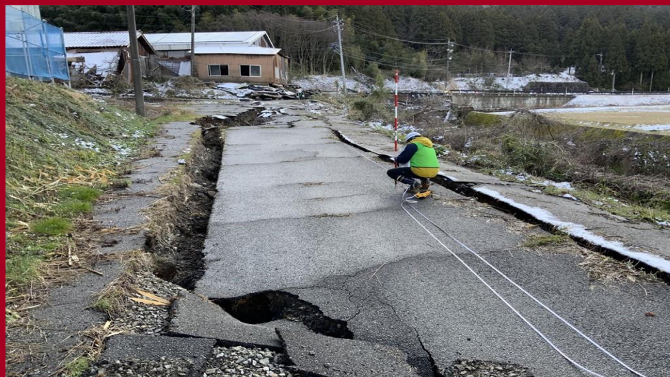
農道被災状況①
