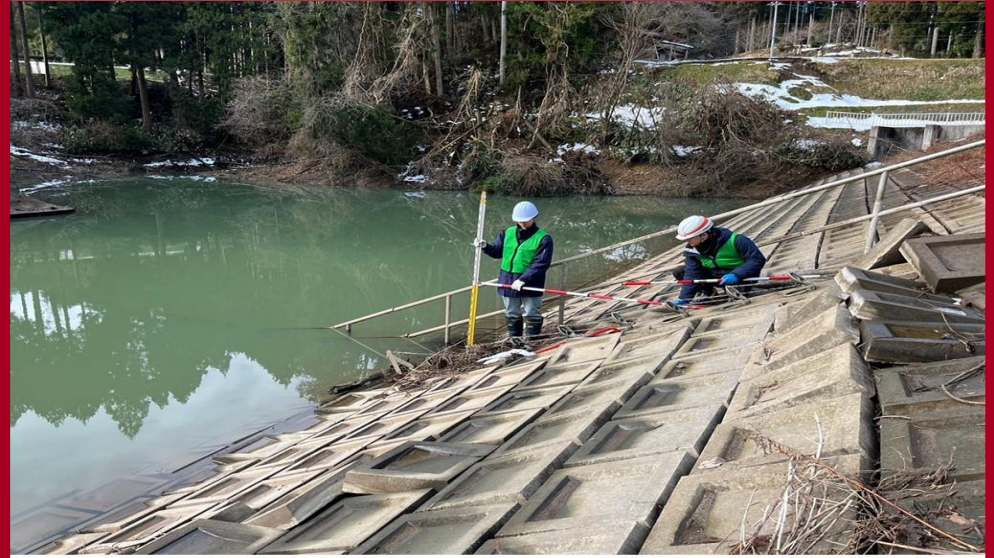
ため池被災状況②
