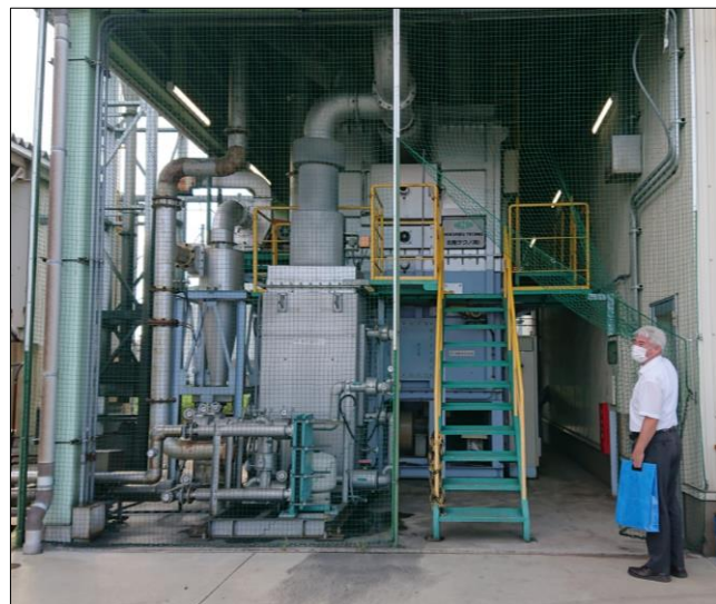
JA いみず野のもみ殻処理実用炉 （同JAのカントリーエレベーター横に設置）
