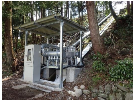
【マイクロ水力発電設備】
