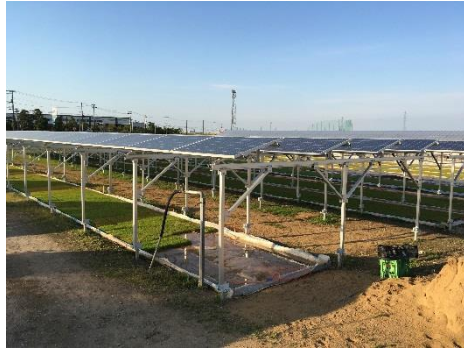
【営農型太陽光発電設備】
