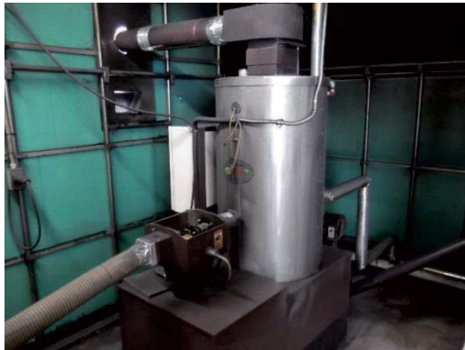
【バイオマス(もみ殻)ボイラー】
