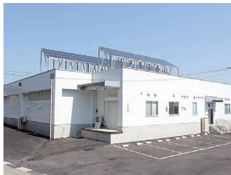
植物工場の屋上に設置された太陽光パネル
